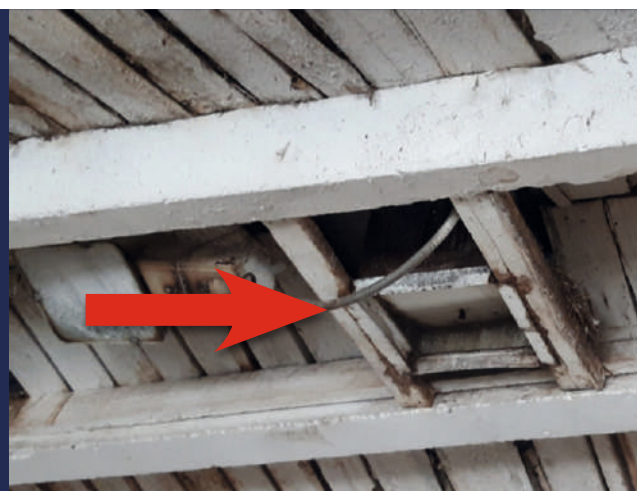
Рис. 2. Шахта естественной вентиляции
